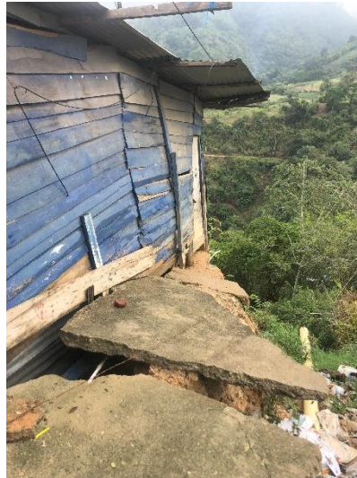
Figura 1 Muchas casas quedan al borde de precipicios con riesgo de que se hundan por las lluvias. Muchas de ellas están hechas de tablonces de madera y tejados de zinc.
